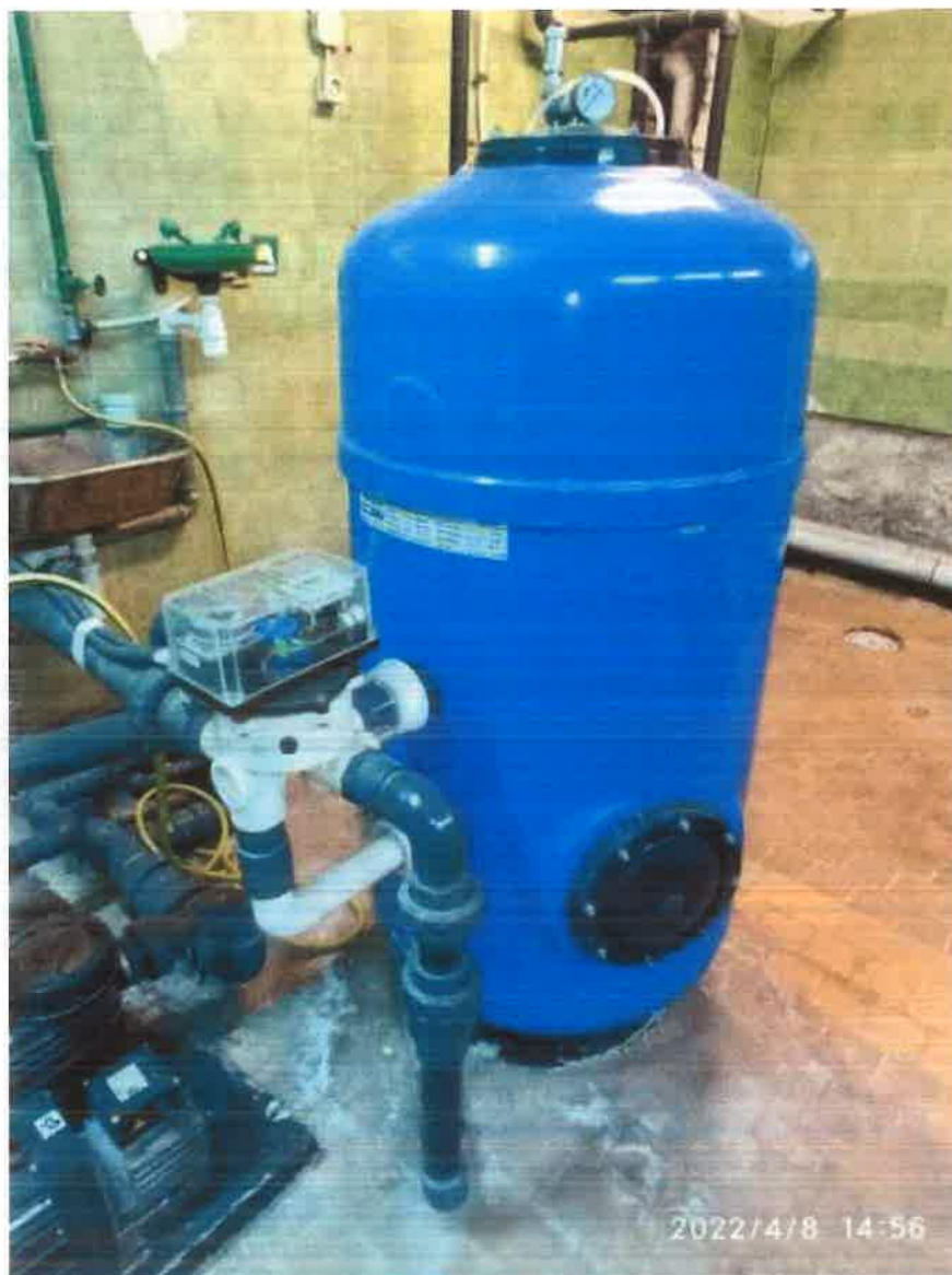
Fot. 31. Filtr z zaworem automatycznym 6-drogowym.
