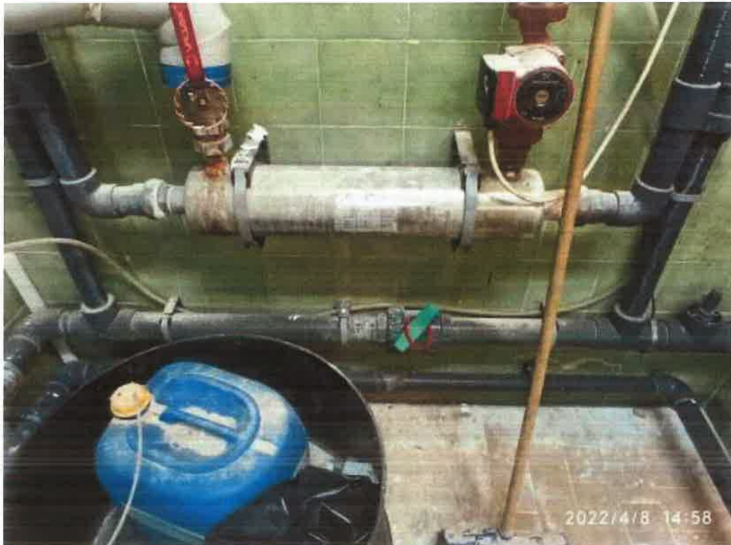
Fot. 36. Wymiennik przeciwprądowy woda grzewcza/woda basenowa.
