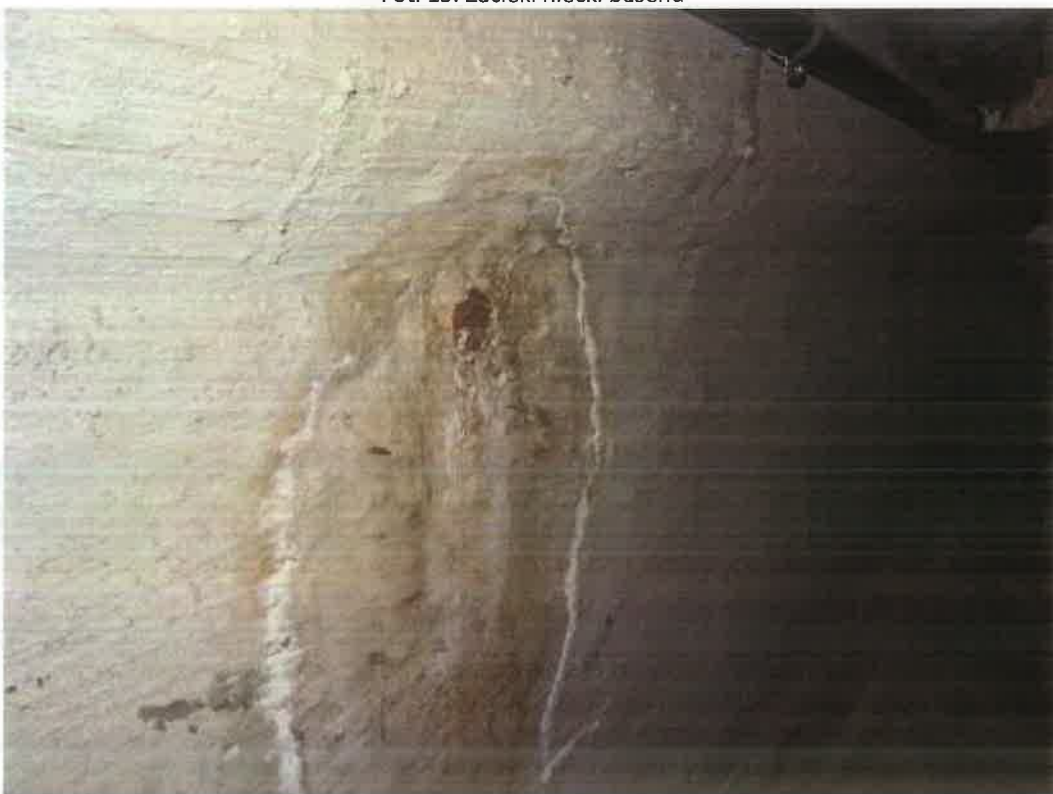
Fot. 16. Zacieki niecki basenu
