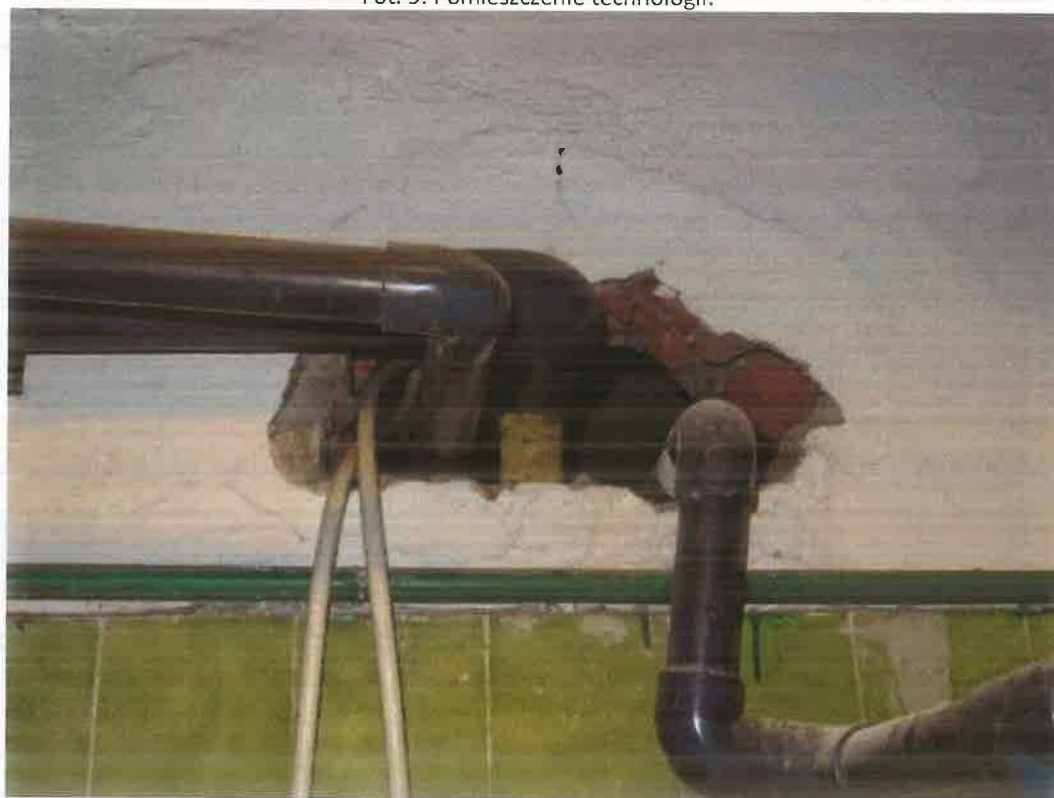
Fot. 10. Pomieszczenie technologii. Brak przejścia instalacyjnego
