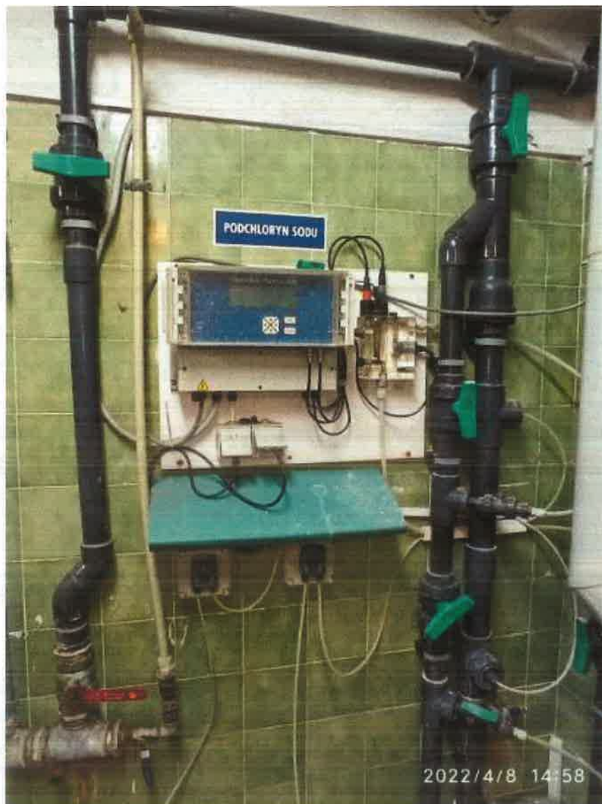
Fot. 27. Układ kontrolny CHEMODATA 999. Widoczna nieprawidłowa pozycja zaworu kulowego.
