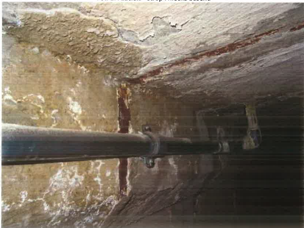
Fot. 18. Korozja elementów stalowych
