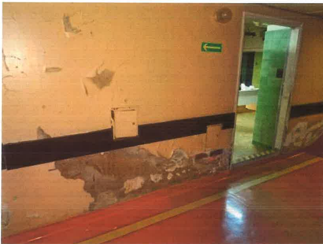
Fot. 5. Zawilgocenie ściany piwnicy
