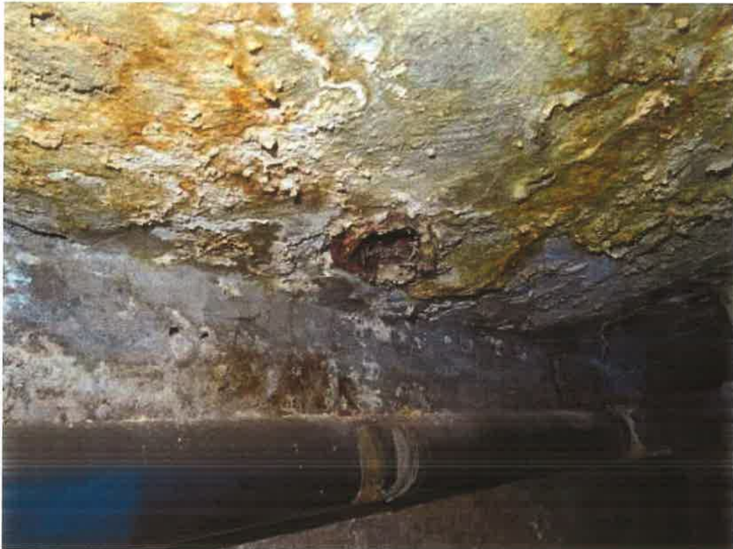
Fot. 17. Zacieki - strop i niecka basenu
