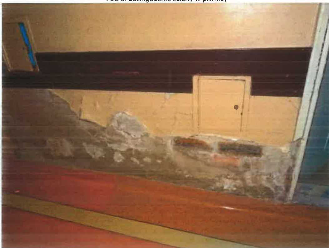
Fot. 4. Zawilgocenie ściany piwnicy
