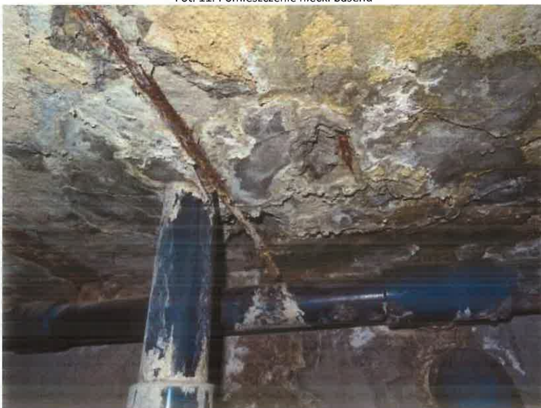
Fot. 12. Zacieki i uszkodzenia stropu
