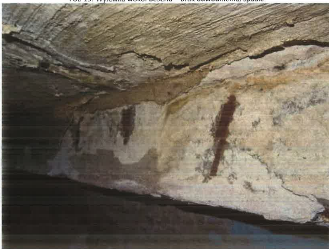
Fot. 20. Korozja zbrojenia
