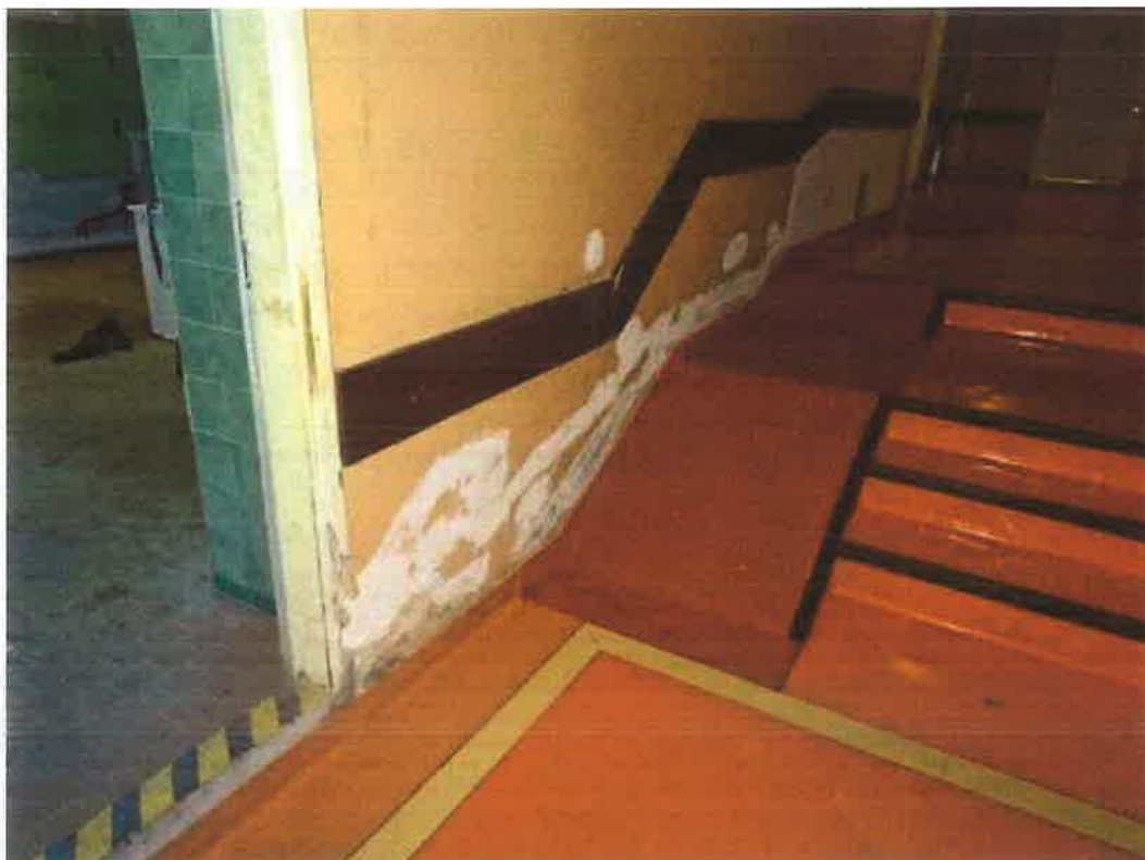
Fot. 3. Zawilgocenie ściany w piwnicy
