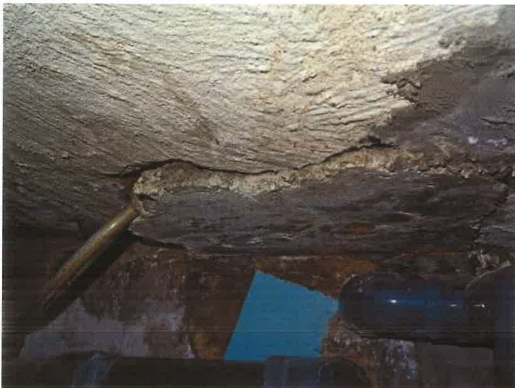
Fot. 13. Uszkodzenia stropu
