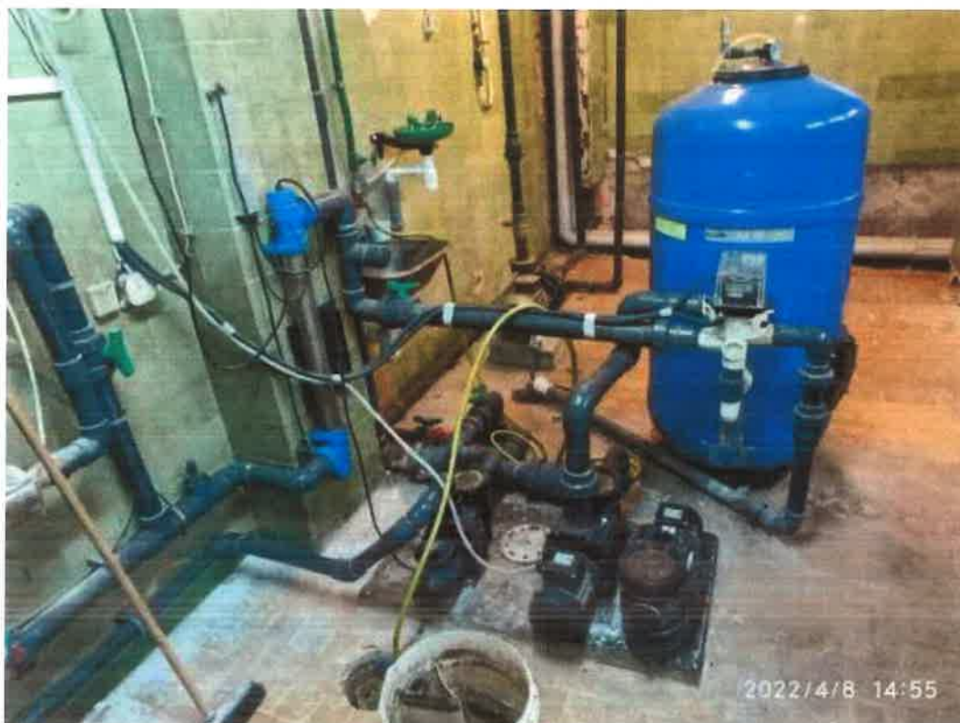
Fot. 30. Układ pomp obiegowych.
