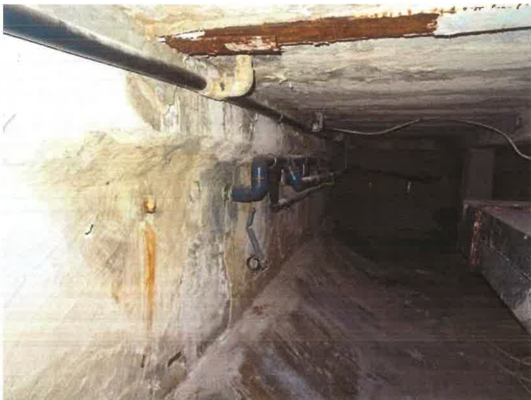
Fot. 19. Wylewka wokół basenu – brak odwodnienia, spadki
