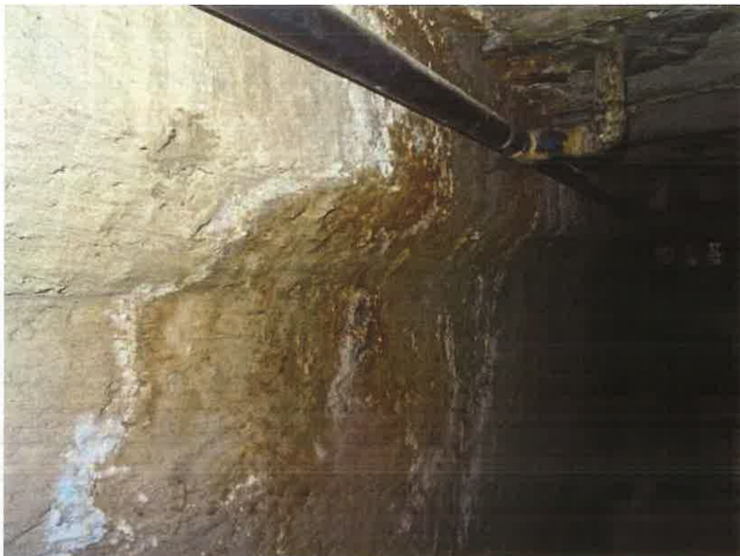
Fot. 15. Zacieki niecki basenu
