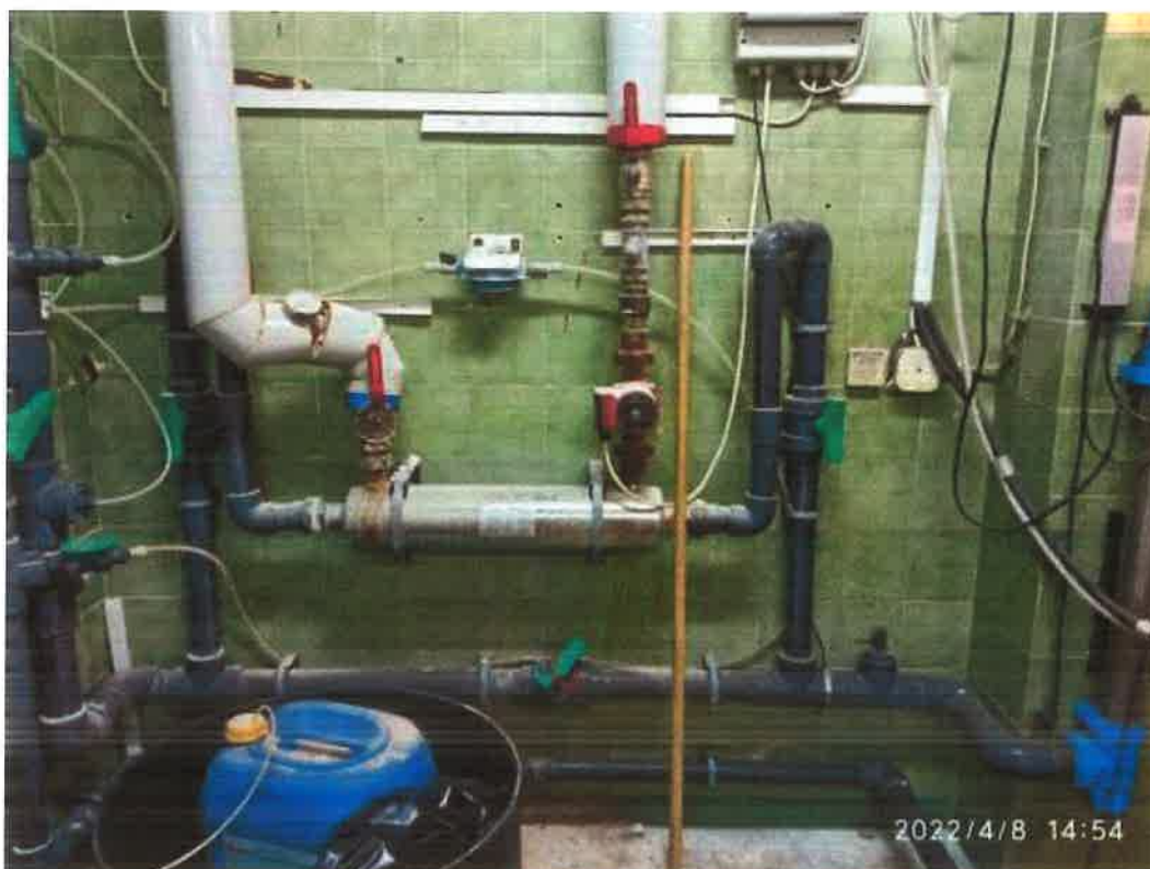
Fot. 28. Układ podgrzewania wody basenowej z wymiennikiem przeciwprądowym woda grzewcza/woda basenowa. Widoczna nieprawidłowa pozycja zaworu kulowego.
