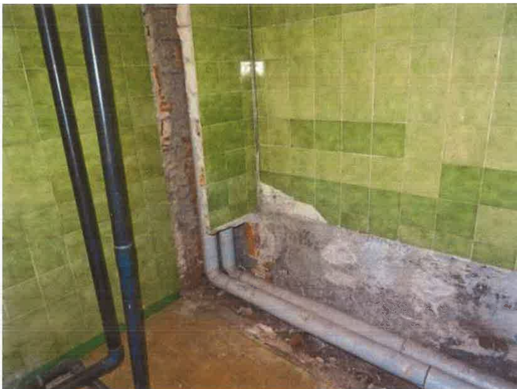
Fot. 7. Pomieszczenie technologii – uszkodzenia ścian
