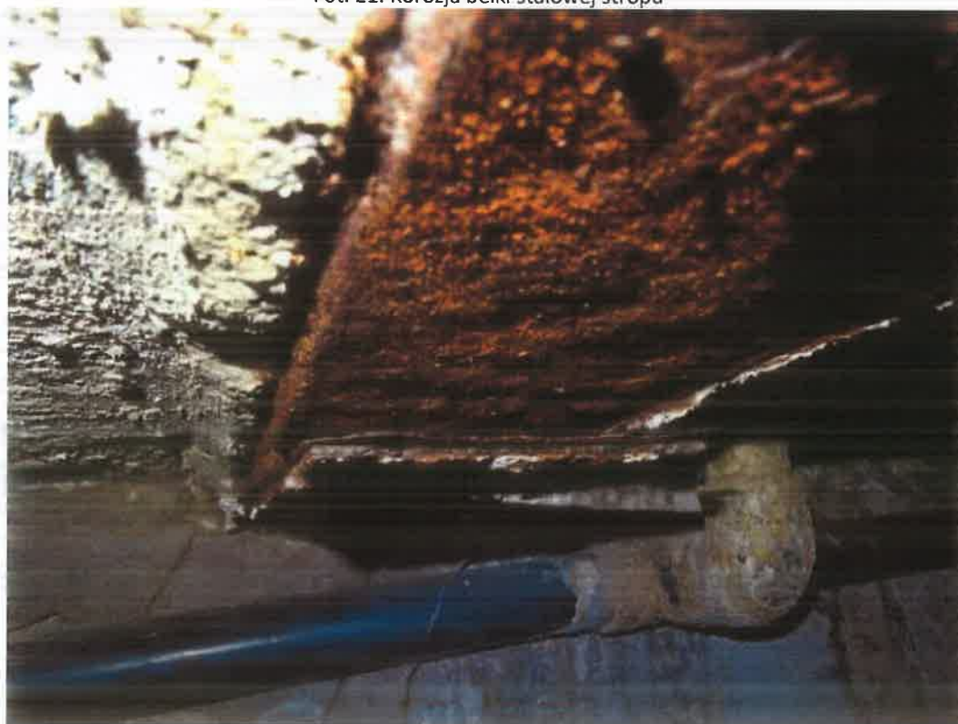
Fot. 22. Korozja belki stropowej
