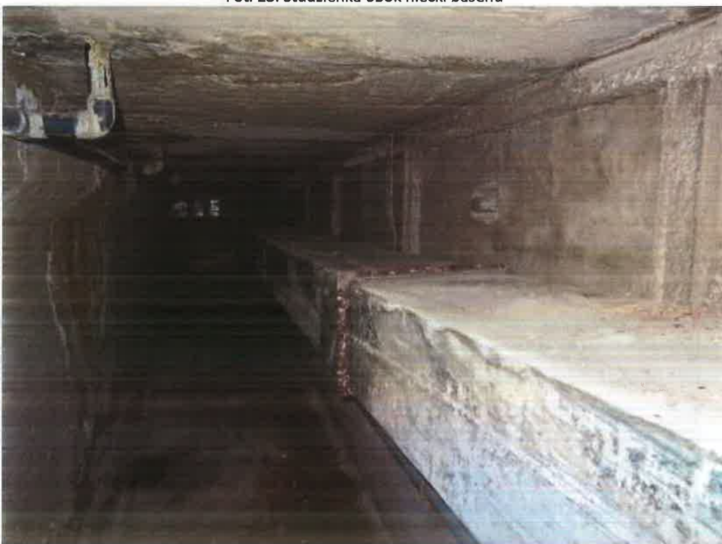
Fot. 24. Posadzka obok basenu – brak odwodnienia, spadki
