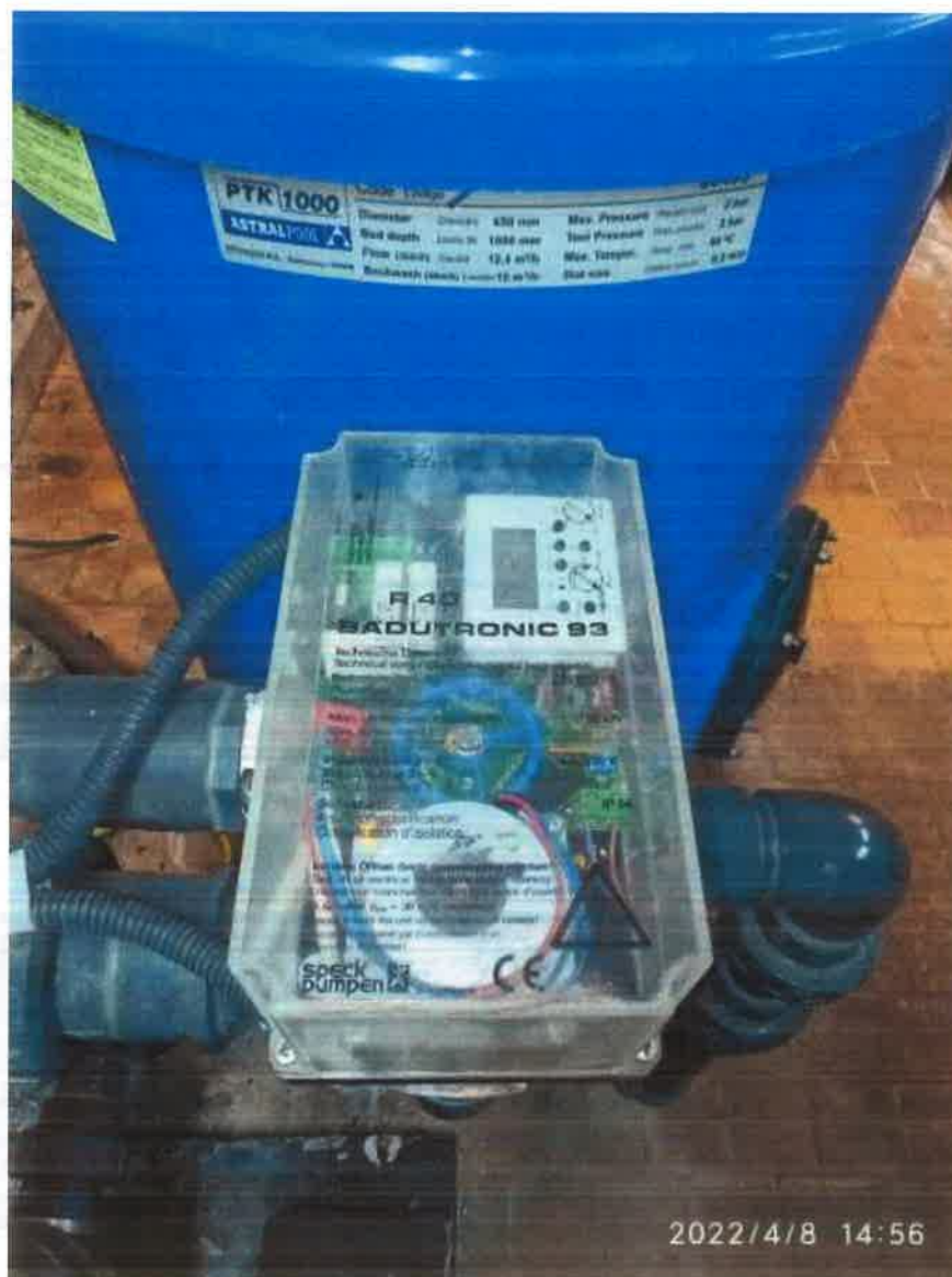
Fot. 32. Układ sterowania pracą zaworu automatycznego 6-drogowego.
