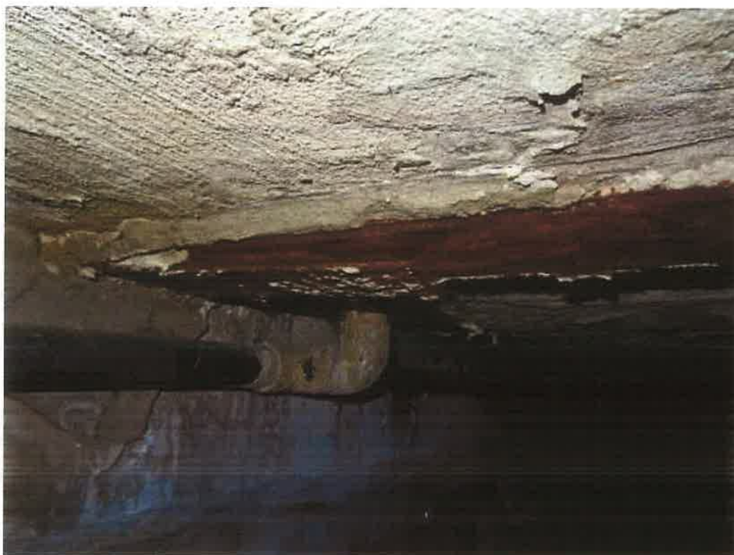
Fot. 21. Korozja belki stalowej stropu
