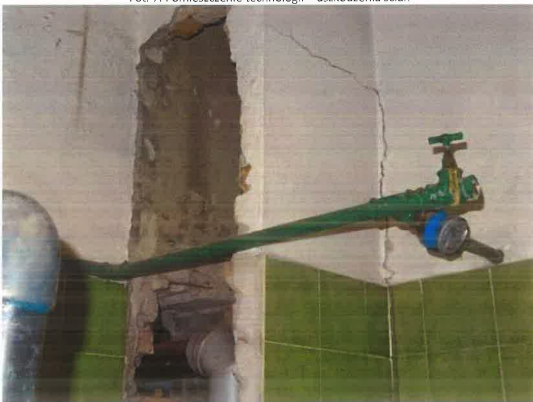
Fot. 8. Pomieszczenie technologii – uszkodzenia szachtu
